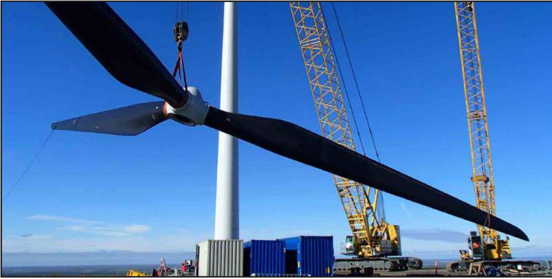
Rotor Blade Install, AVEC Saint Mary's and Bethel Wind Sites, STG, Inc.
